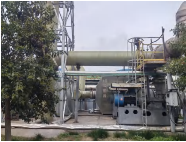
厂区污水处理站除臭生物除臭塔及活性炭装置
