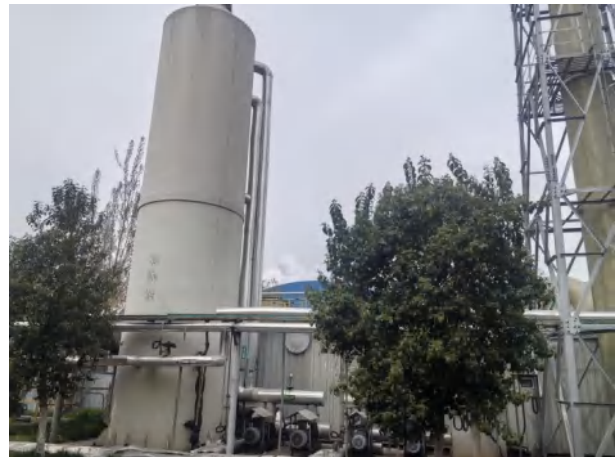
厂区污水处理除臭碱洗塔装置
