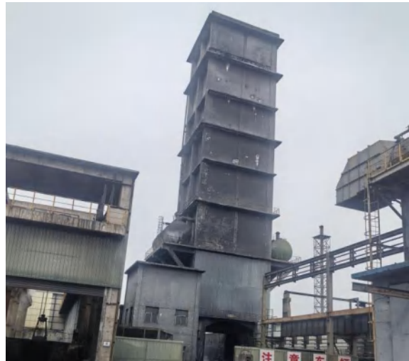
厂区现有湿熄焦装置
