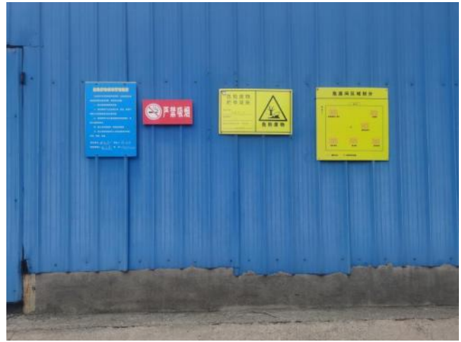
厂区现有危废暂存间
