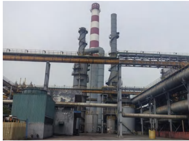
焦炉废气治理设施
