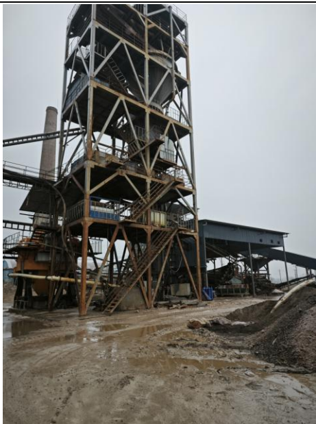
未批先建现场
